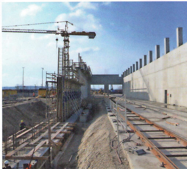
Die Lech-Stahlwerke bauen: Blick auf die Walzwerkerneuerung und -erweiterung am Standort Meitingen.
